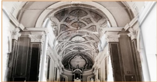
Fig. 4 Forastamento della volta dell'abside e della parte di separazione tra navata e presbitero.
