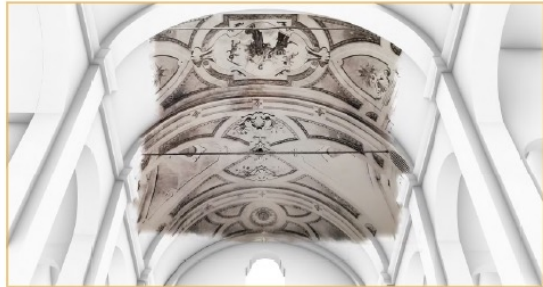
Fig. 3 Forastamento della volta della navata centrale.
