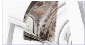
Fig. 5 Forastamento della volta dell'ultima cappella, lato destro.
